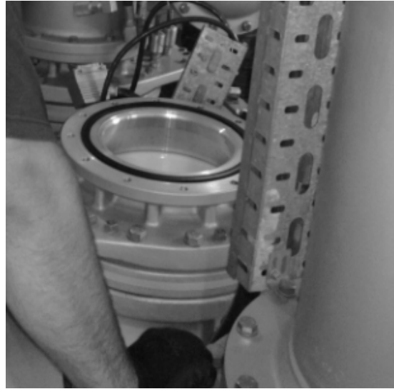
Slika 7. Pozicija provodnog izolatora
